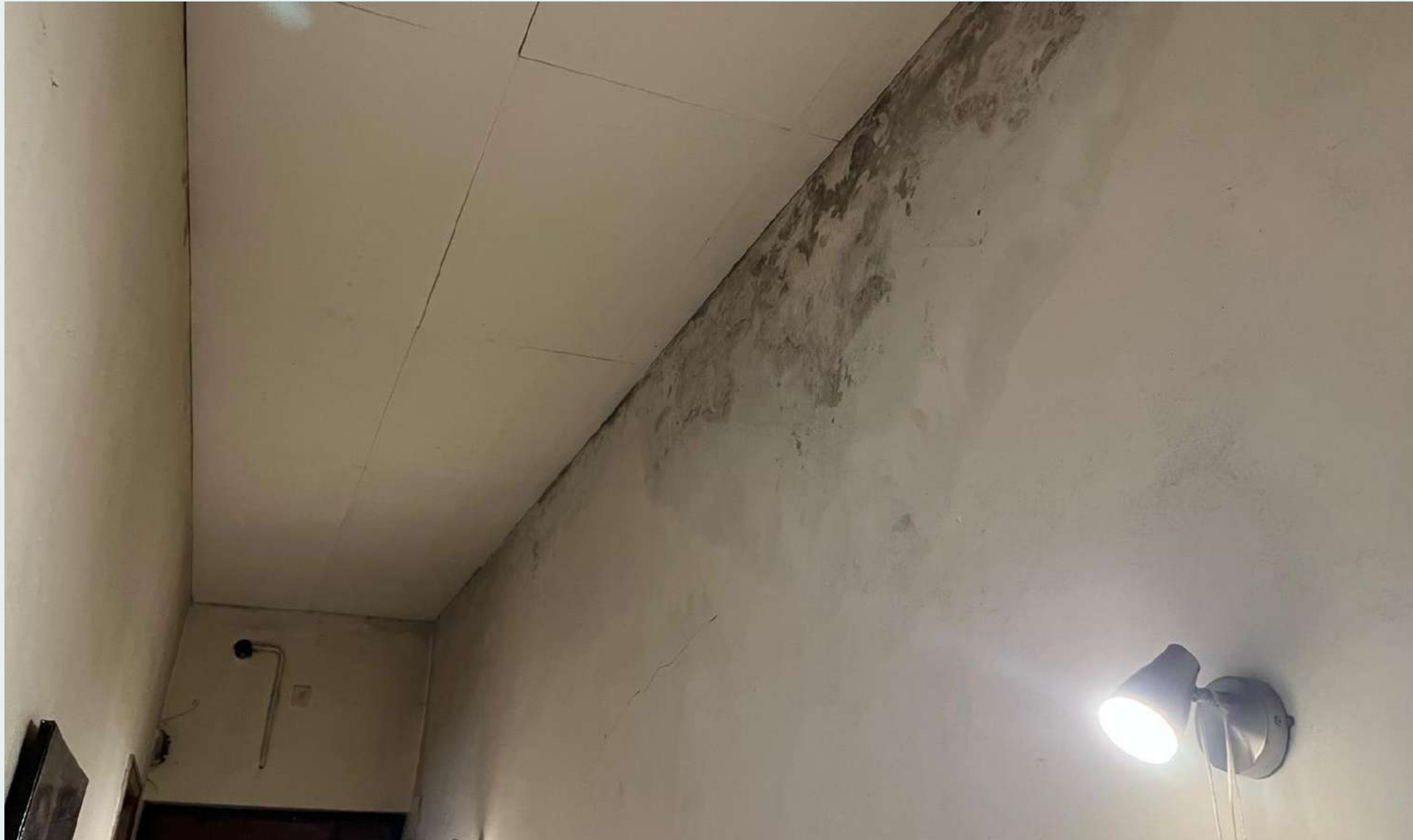
Intervento di isolamento da «bricolage» non risolutivo.
