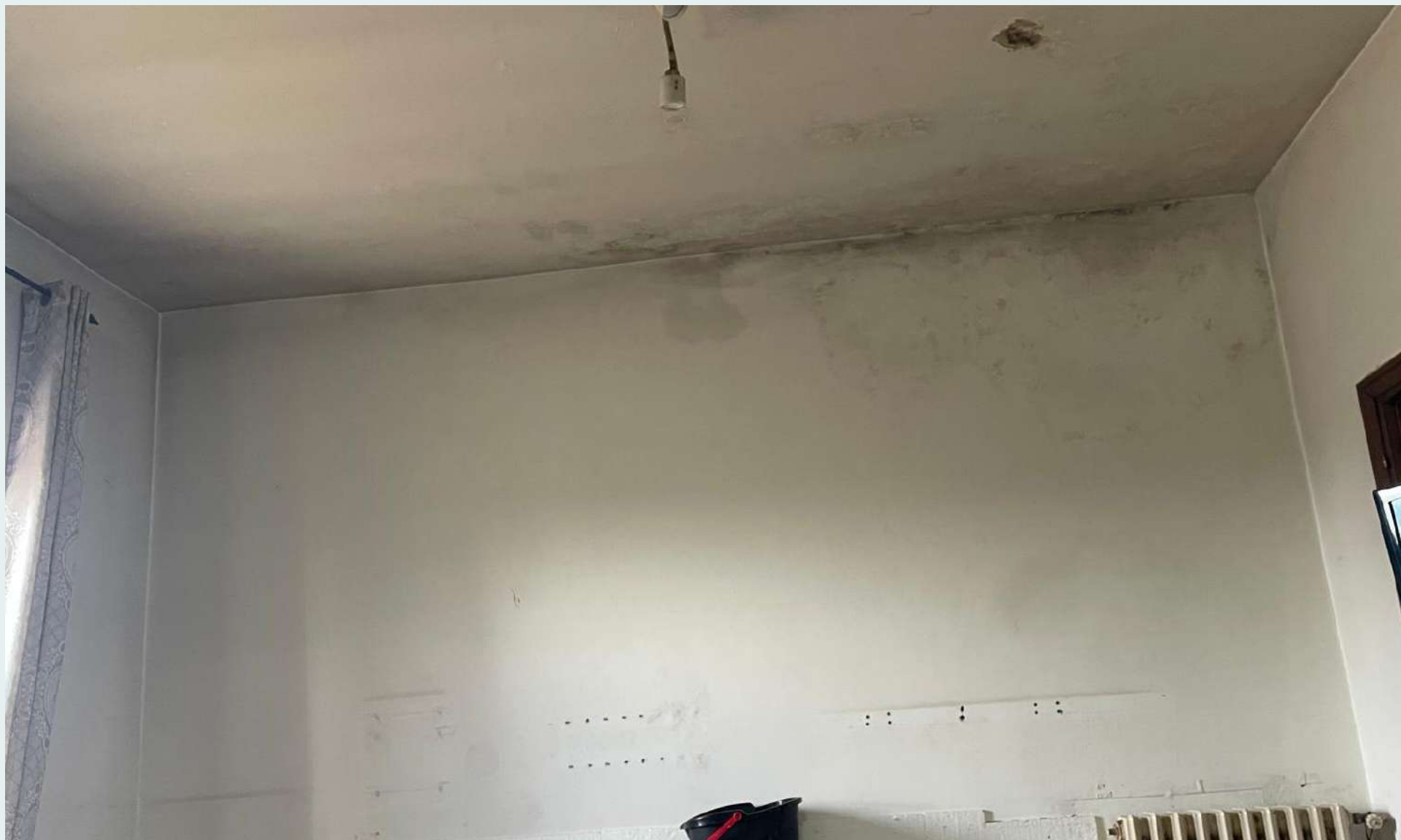
Infiltrazioni dalla copertura
