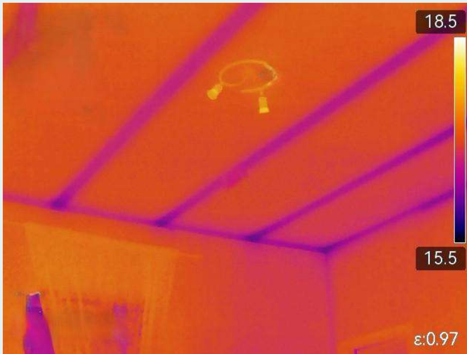
La termografia mostra la trama del solaio con l'evidenza della travatura in acciaio (putrelle)
