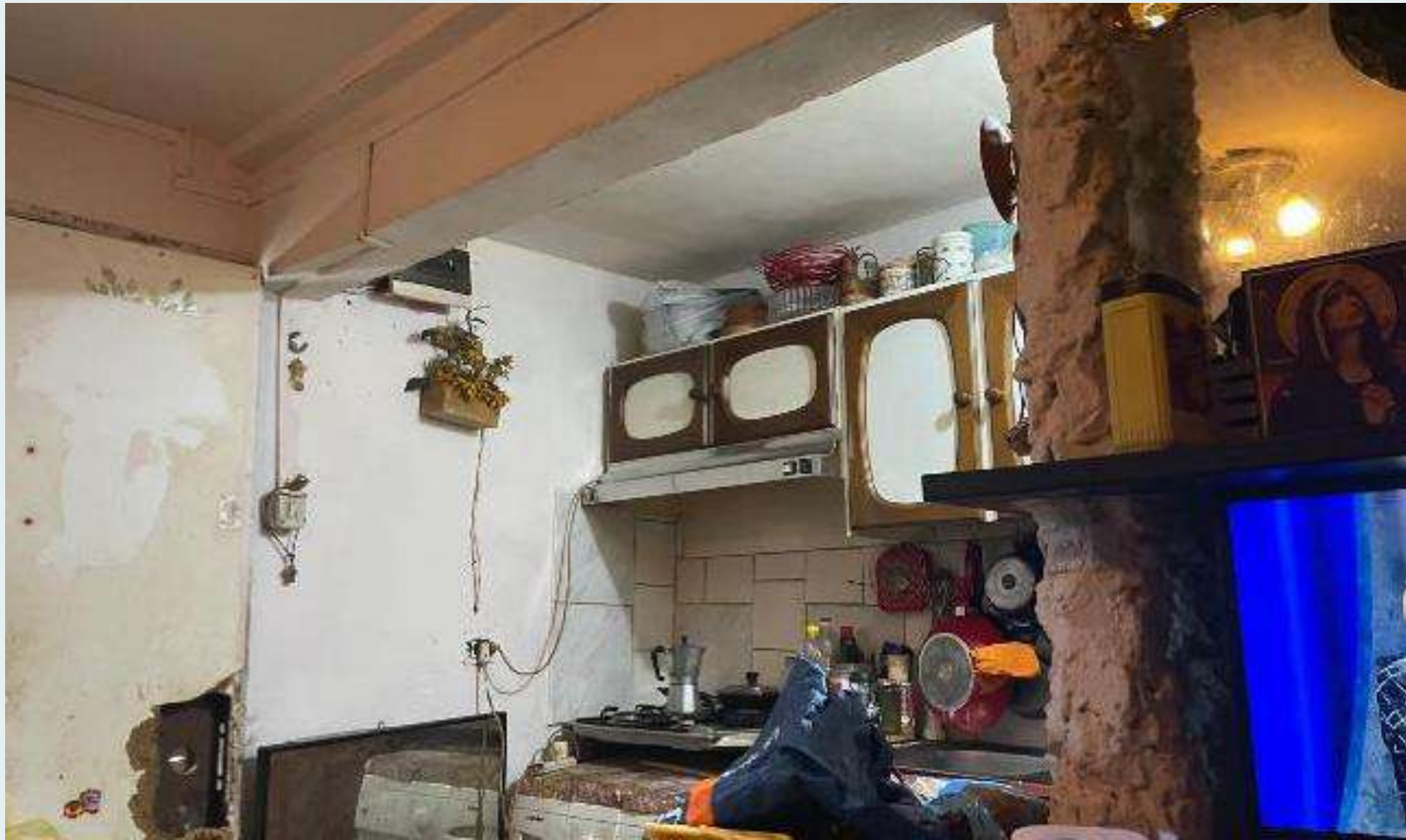
30 metri quadri, soffitto ribassato, aperture insufficienti, umidità elevata
